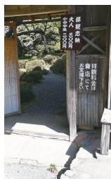
庭に通じる木戸に1段の段差
